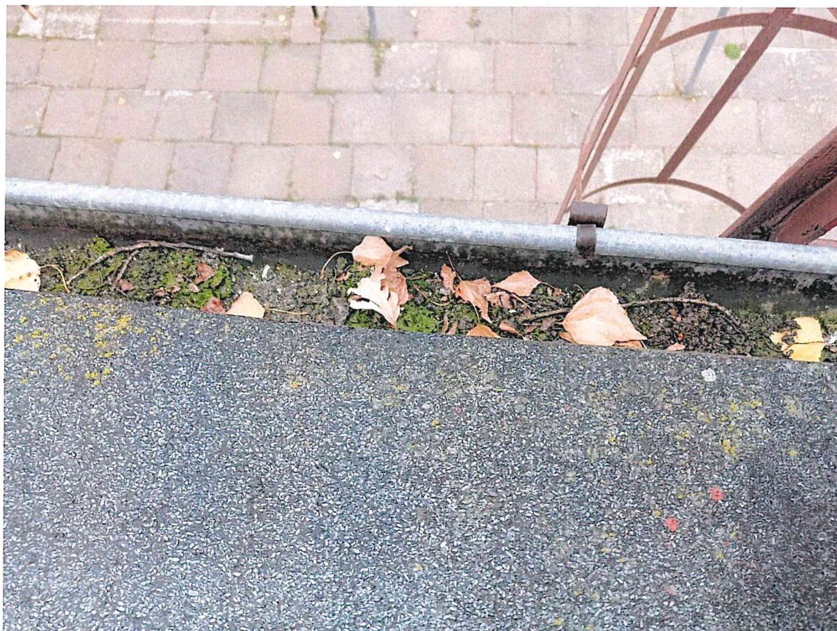
Zdjęcie nr 10 – skorodowana nieoczyszczona rynna fi 120 przeznaczona do wymiany na nową.
