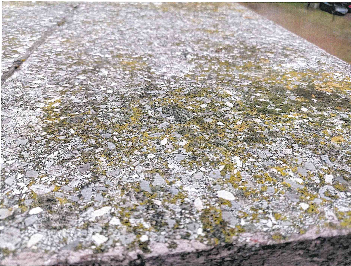
Zdjęcie nr 9 – widoczna korozja biologiczna na czapce kominowej.
