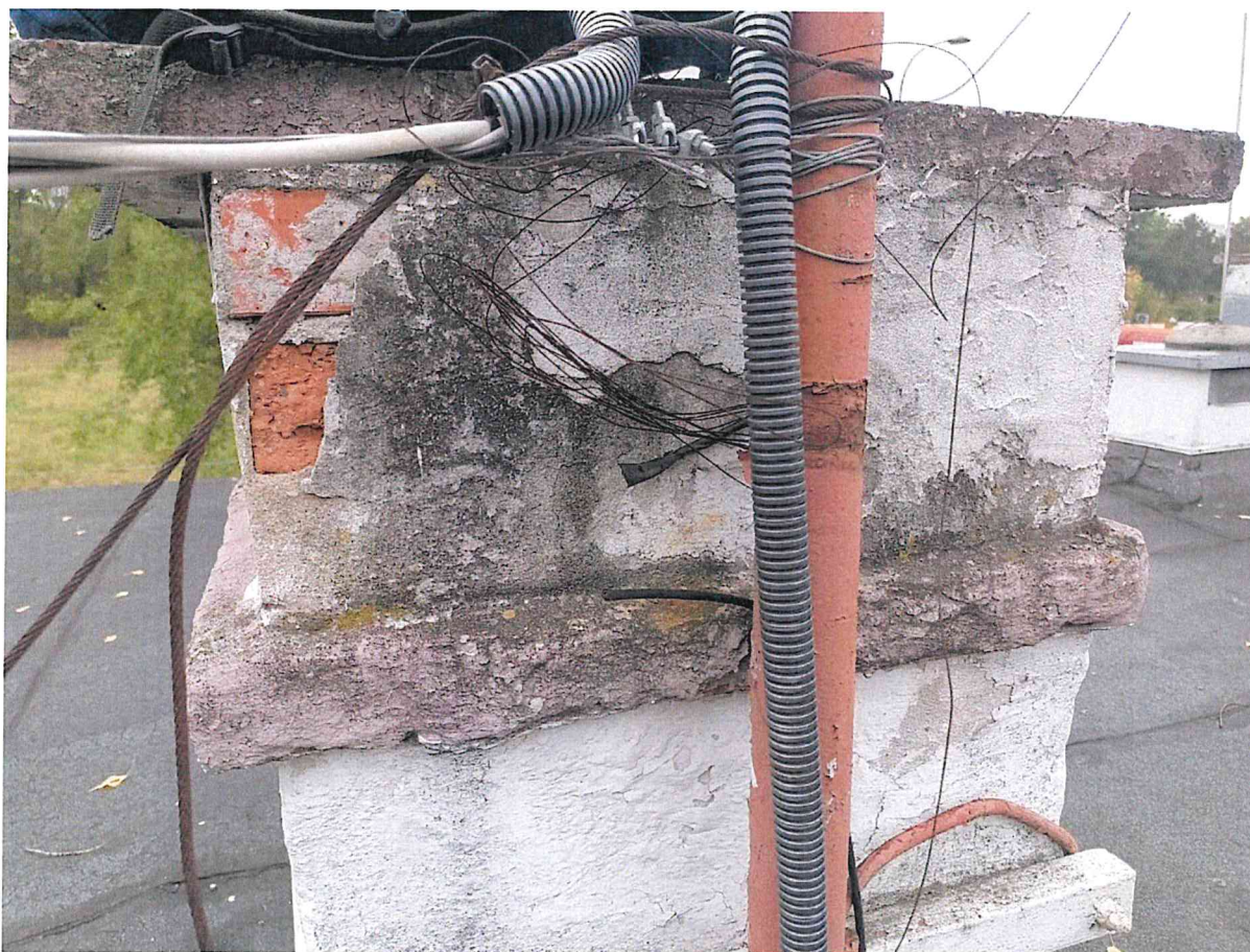
Zdjęcie nr 11 – widok uszkodzonego komina na dachu budynku.
