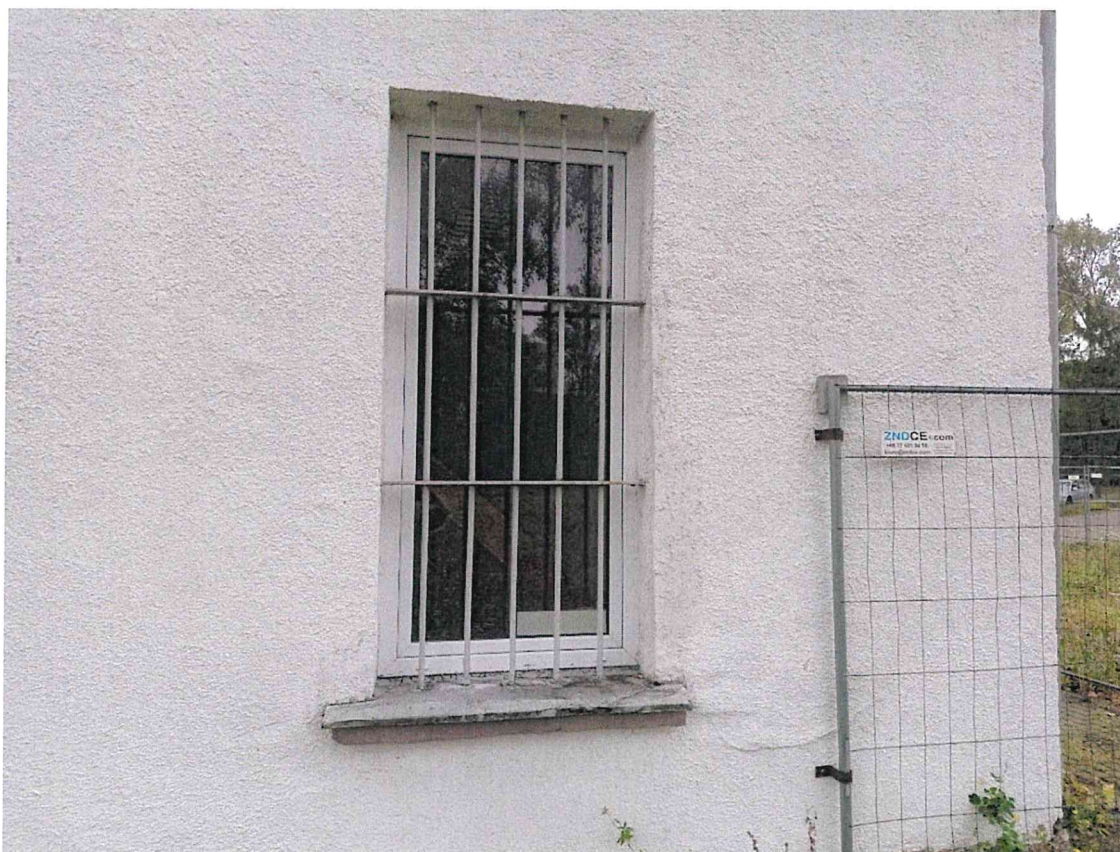
Zdjęcie nr 27 – elewacja zachodnia, krata stalowa w oknie do malowania, parapet do wymiany na nowy z blachy budowlanej ocynkowanej.
