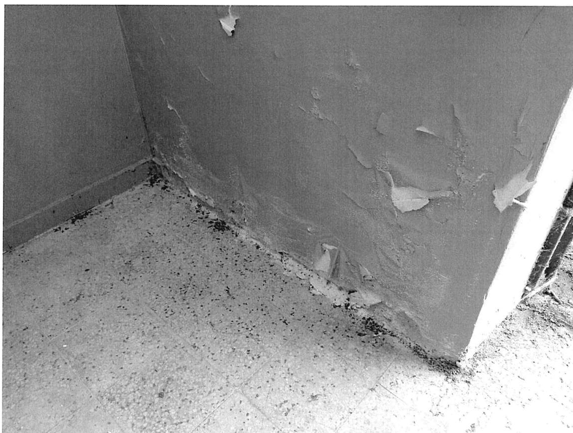
Zdjęcie nr 24 – pomieszczenie zaplecza, zmurszałe i odparzone tynki na ścianach lamperii.
