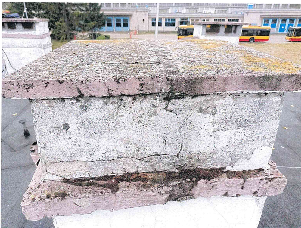
Zdjęcie nr 4 – uszkodzony komin na dachu budynku portierni.
