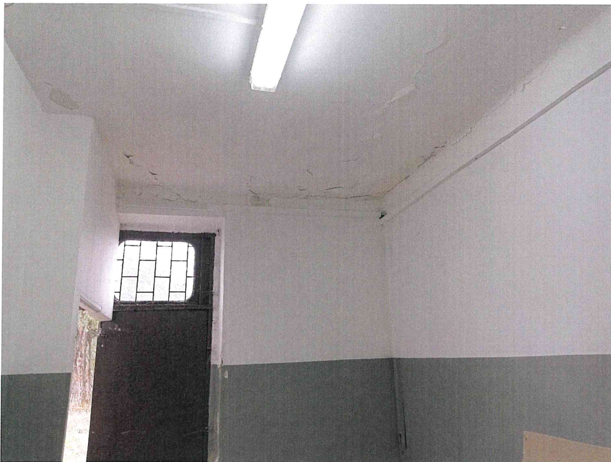
Zdjęcie nr 25 – pomieszczenie zaplecza, uszkodzone tynki na powierzchni sufitu.
