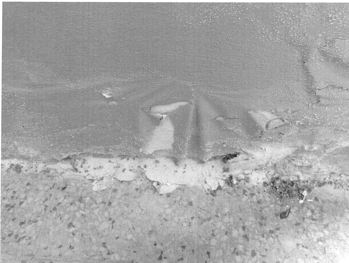
Zdjęcie nr 23 – pomieszczenie zaplecza, widoczne zmurszałe tynki w strefie cokołowej.
