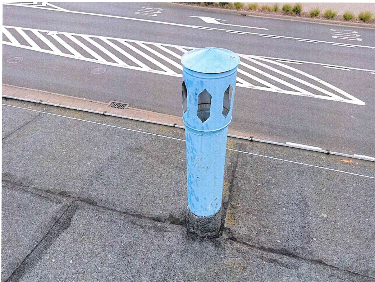
Zdjęcie nr 8 – wywiewka kanalizacyjna przeznaczona do malowania.
