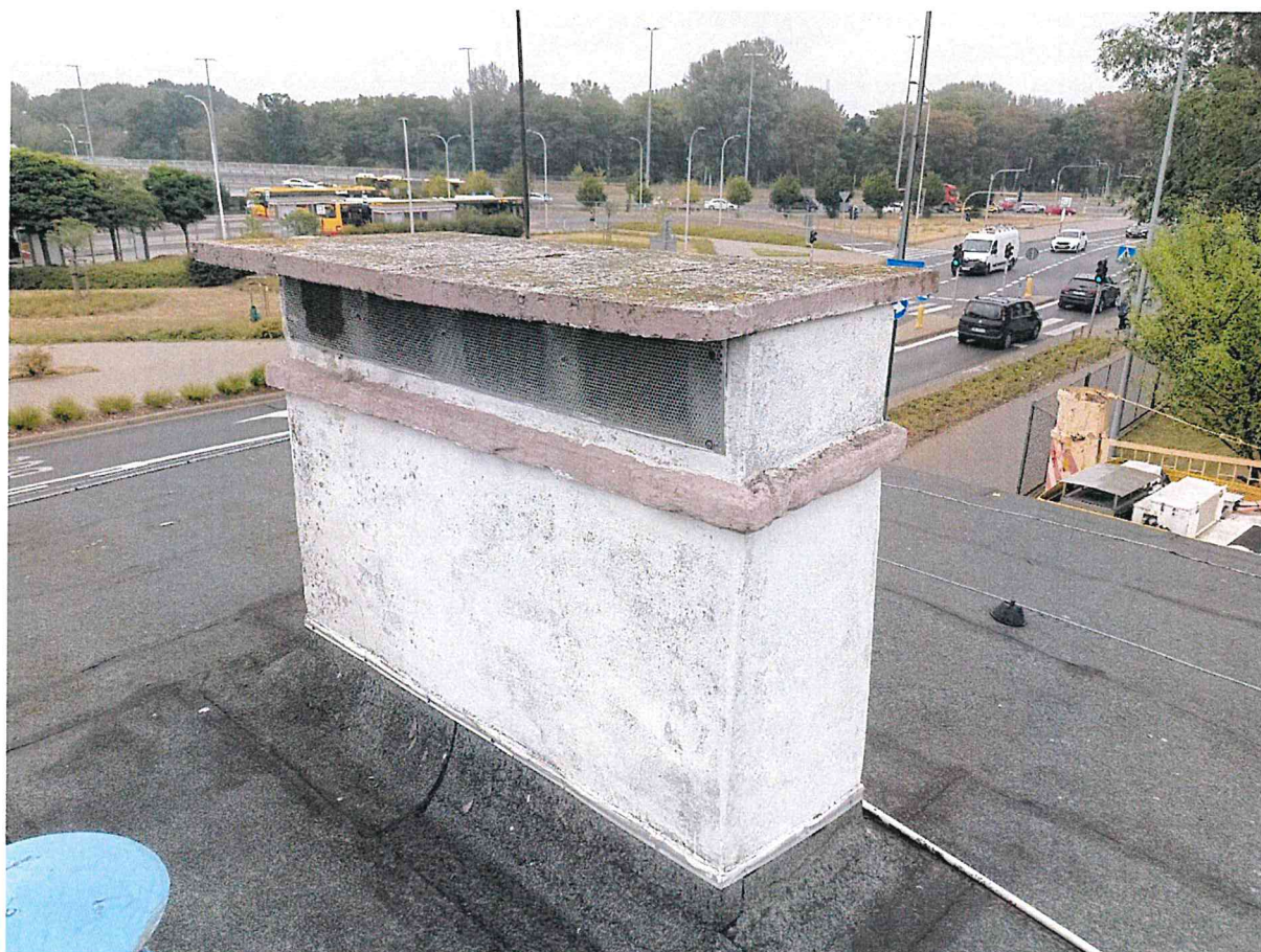
Zdjęcie nr 12 – komin na dachu budynku przeznaczony do remontu razem z czapką kominową.
