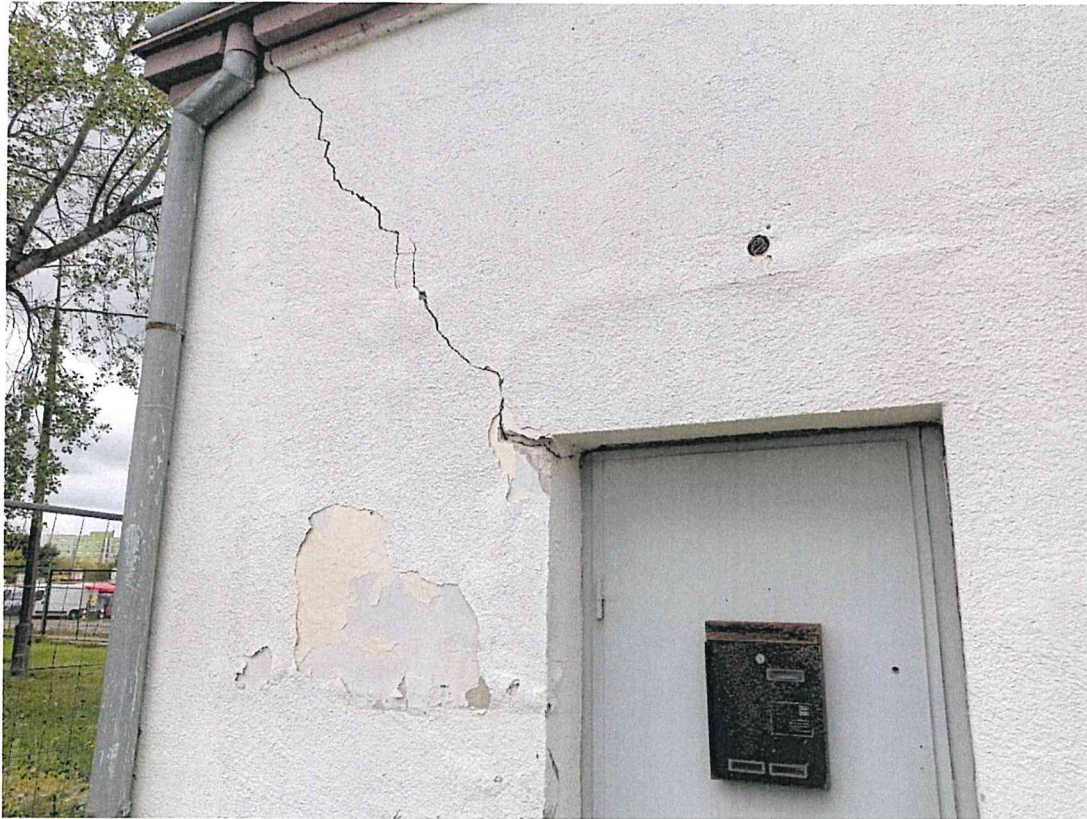
Zdjęcie nr 19 – widok pękniętej ściany w elewacji południowej. Zamawiający zaplanował miejscową rozbiórkę uszkodzonej ściany z wyparciem stropu, wymurowanie nowej ściany z wykonaniem nowego nadproża i montażem nowych stalowych ocieplonych drzwi.
