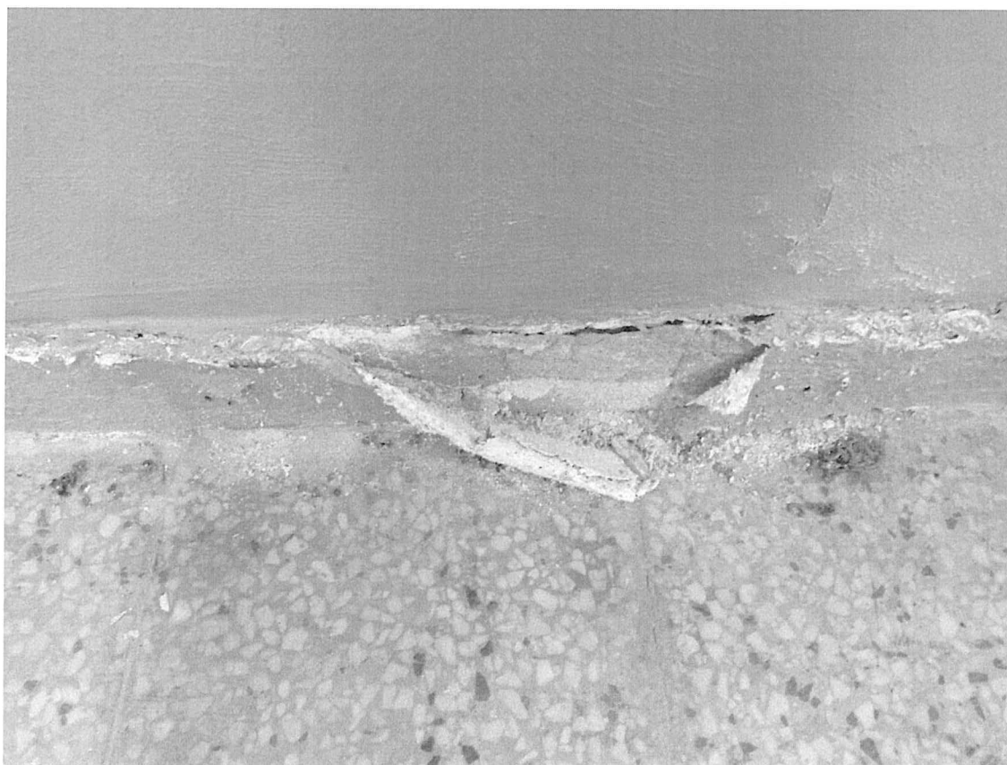
Zdjęcie nr 22 – pomieszczenie zaplecza, widoczne zmurszałe tynki w strefie cokołowej.
