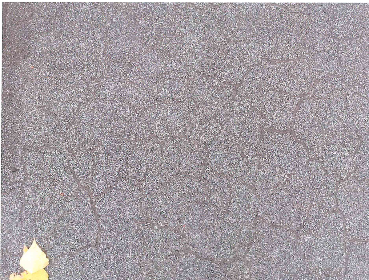
Zdjęcie nr 7 – skorodowana popękana papa na dachu budynku portierni.
