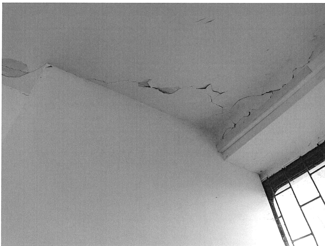
Zdjęcie nr 18 – widok powierzchni sufitu z widocznymi rysami i odparzeniami pokrycia z farby.
