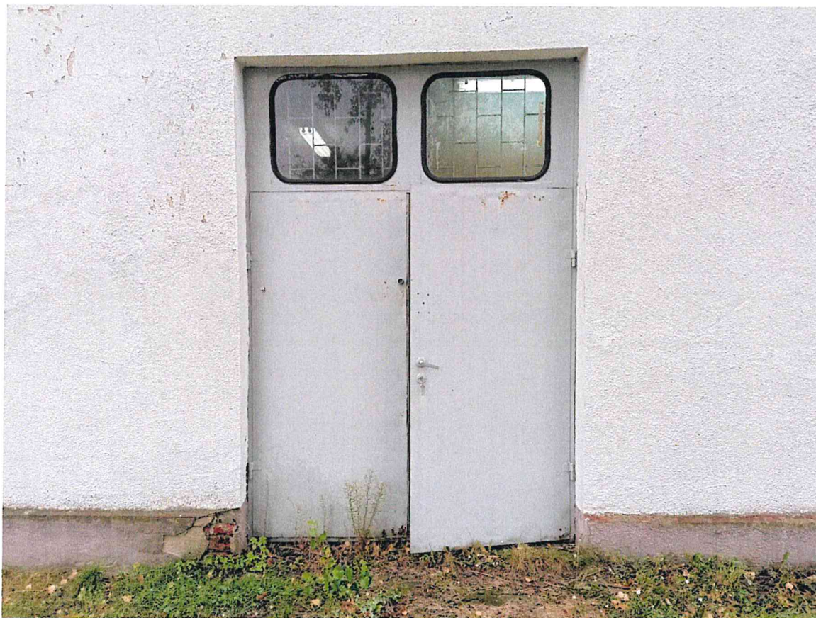
Zdjęcie nr 13 – skorodowane stalowe drzwi na elewacji zachodniej przeznaczone do wymiany na nowe drzwi stalowe dwuskrzydłowe ocieplone.
